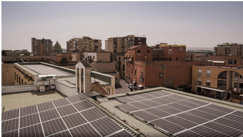
Figura 2.5 - Impianto FV installato sul tetto della Fondazione di Maria a San Giovanni a Teduccio, Napoli.
